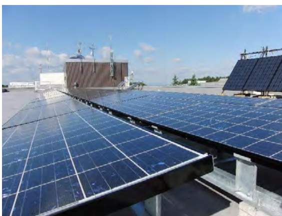
図 7-24 太陽光発電設備
