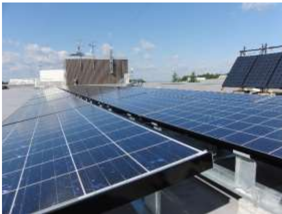
図 7-18 太陽光発電設備
