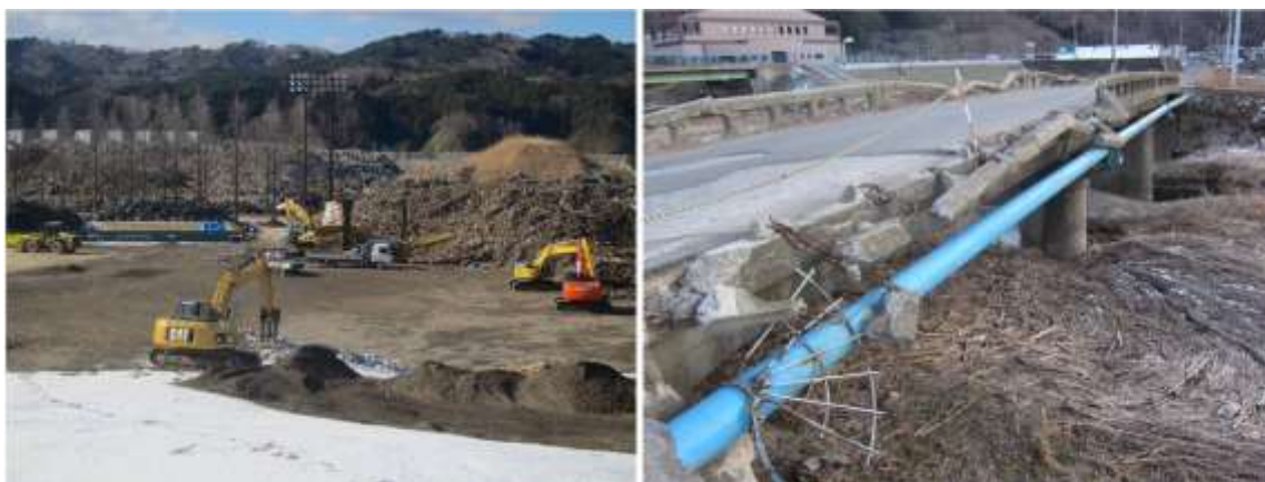
災害廃棄物仮置場（岩手県宮古市赤前地区） 水道管の被害（岩手県宮古市田老地区）
