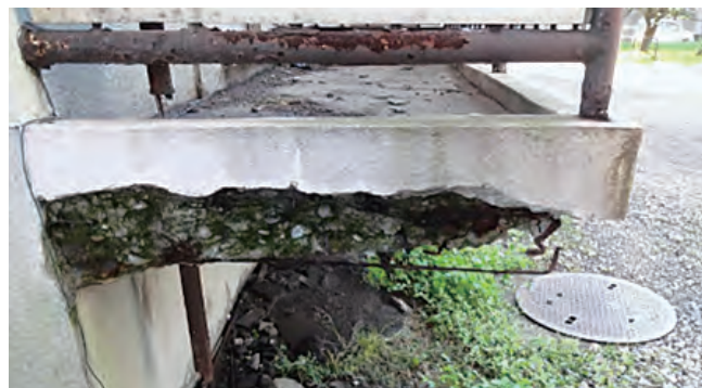
凍害によるベランダの損傷
